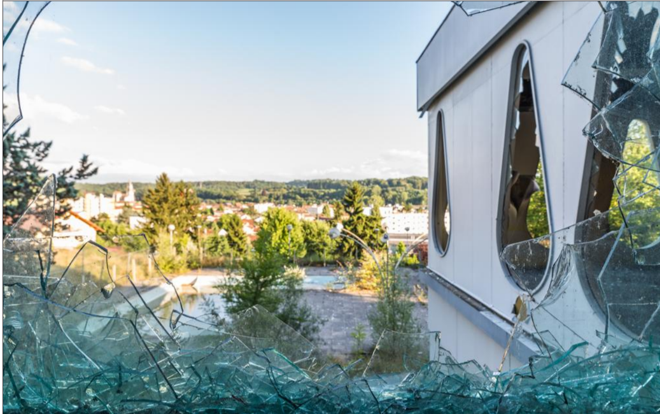
Les vitres des différentes chambres sont brisées, mais offrent une belle vue sur la ville. Photo Olivier CRETIN
